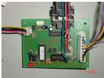
Detalhe do Link de controle
