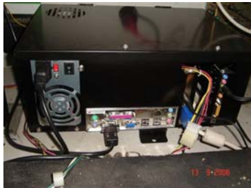
Detalhe da instalação da CPU na Jukebox
